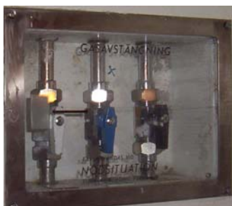
Gammal nödväxlingslåda för andningsoxygen, lustgas och andningsluft Denna typ av NAV skall bytas ut på grund av för stor läckagerisk.
