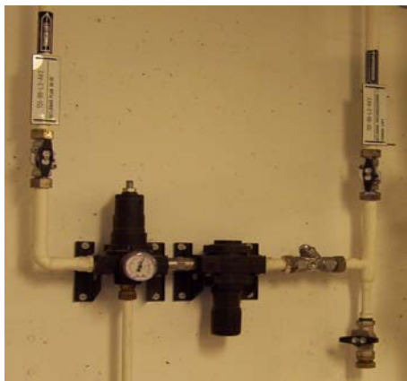
Instrumentluft reduceras till teknisk luft.
