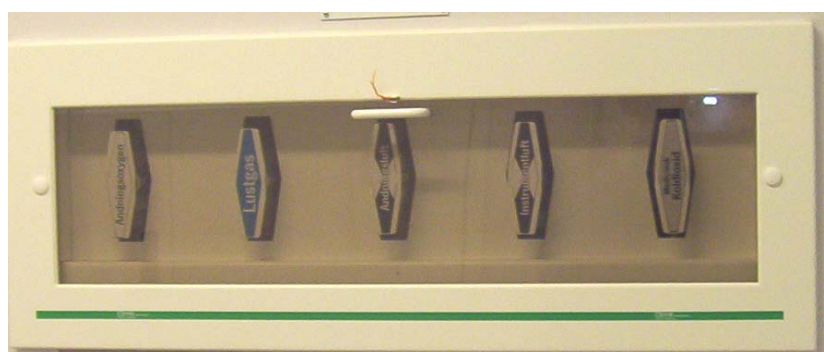
Nödväxlingslåda för andningsoxygen, lustgas, andningsluft, instrumentluft och medicinsk koldioxid.
